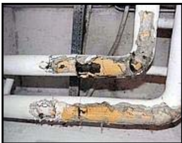
In via Ugo Tommei a Milano all'interno delle case popolari dell'Aler i condomini trovano tubature rivestite di amianto (Fotogramma)
